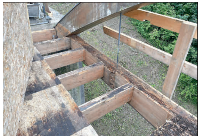
Fäulnis an den Untergurten am südlichen Teil der Brücke nach Entfernen der Mehrschichtplatten.
